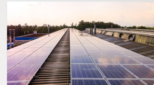
Impianto Fotovoltaico da 999 kWe
