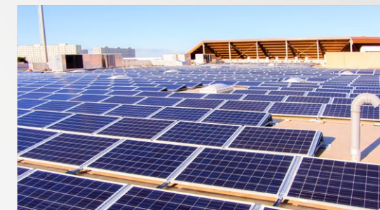
Impianto Fotovoltaico da 350 kWe
